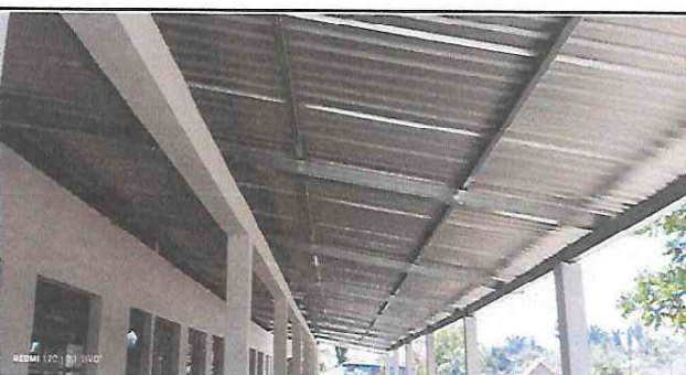
Foto 4: Panorama de nueva instalación de la EORM del Módulo 1
